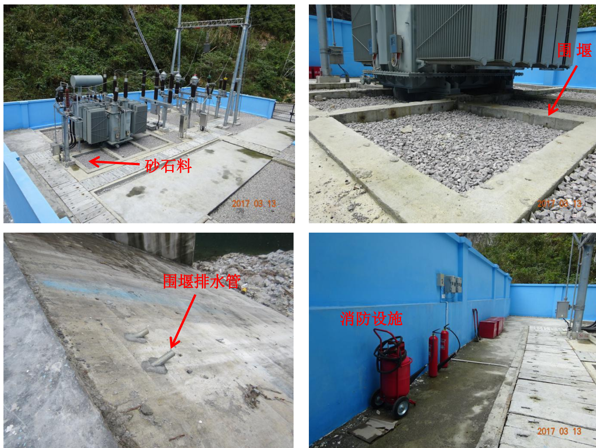
图 7.3-1 升压站应急设施
