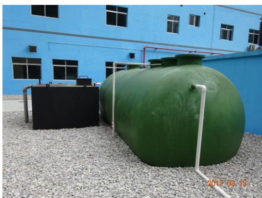
升压站旁的一体化污水处理设施
