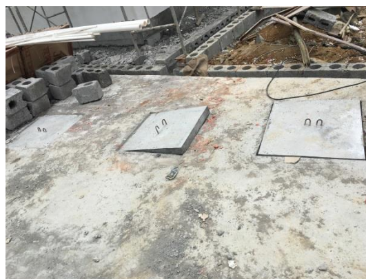
电站居住区三级化粪池
